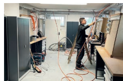
Die Auszubildenden der Schneider Elektro GmbH bei der Installation der hauseigenen Lehrwerkstatt.
